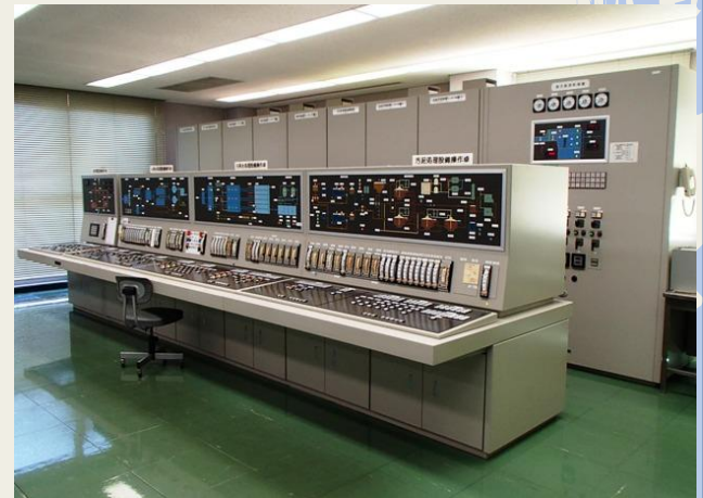
施設の心臓部の監視制御システム
