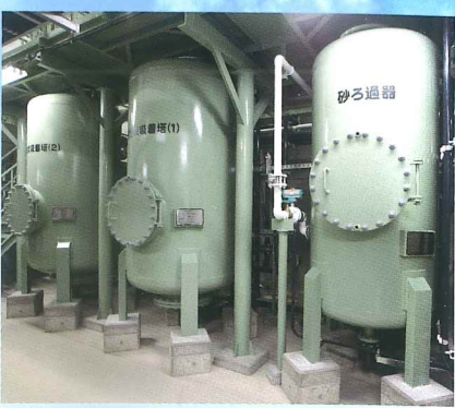
▲砂ろ過・活性炭吸着設備
