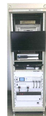
漏水検知モニター
