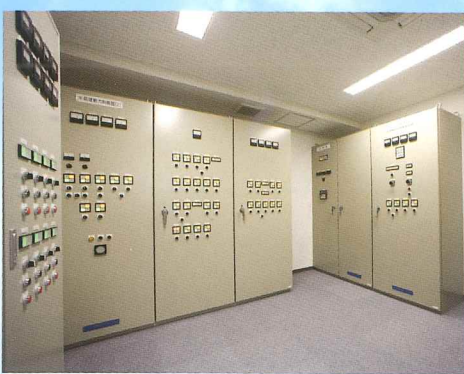
▲監視・操作盤室
