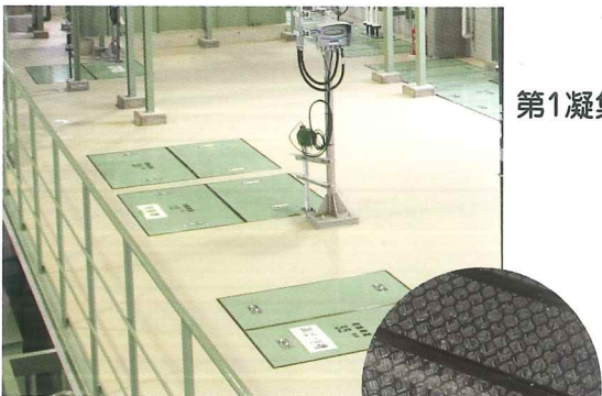
▲生物処理設備
