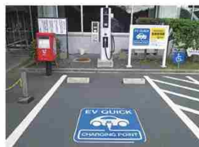
市役所本庁前の急速充電器
