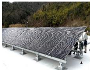
【屋上の太陽光パネル】
