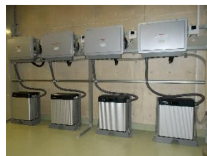
【パワーコンディショナ+蓄電池】
