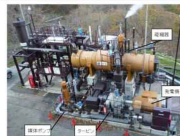
【土湯温泉バイナリー発電設備】
