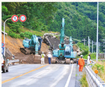
7月豪雨で甚大な被害 平成30年
