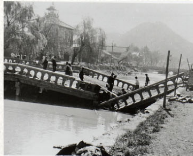
台風13号で壊れた万代橋 昭和28年
