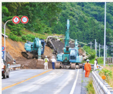
7月豪雨で甚大な被害 平成30年
