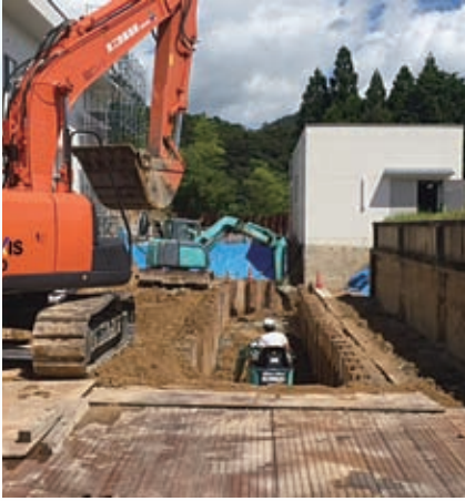
▲上福井浄水場の施設更新
