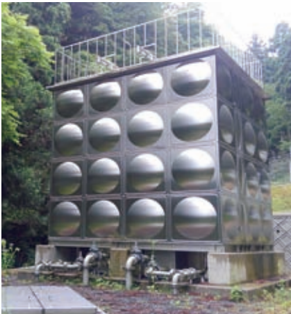
▲岸谷配水池(西地区(池内)簡易水道統合整備事業)
