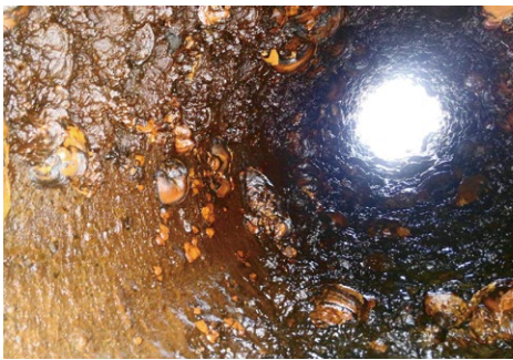
▲さびた水道管内
