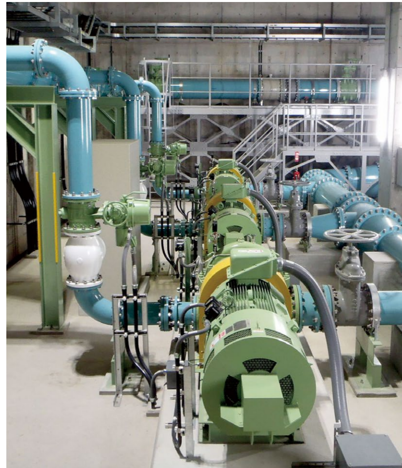
▲上福井浄水場 新ポンプ設備
