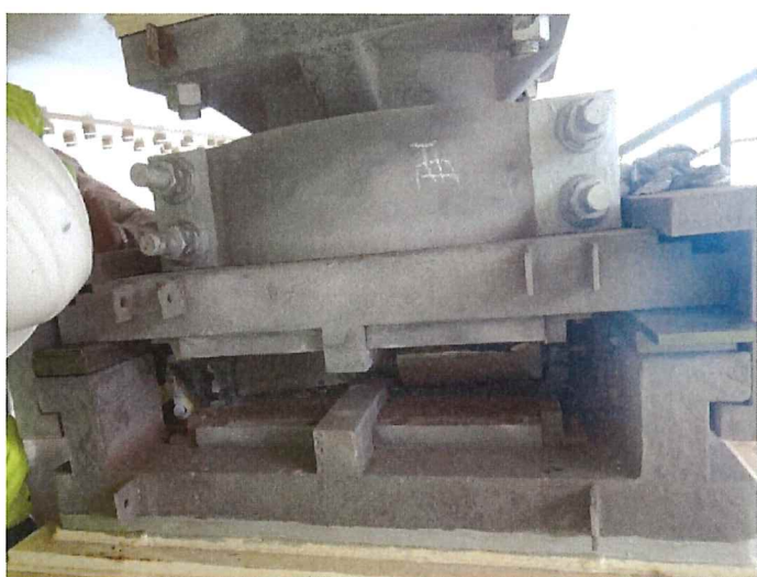
損傷した支承
