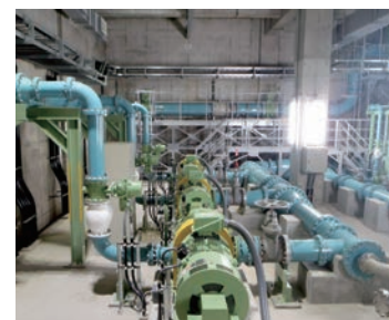
▲上福井浄水場新ポンプ設備
