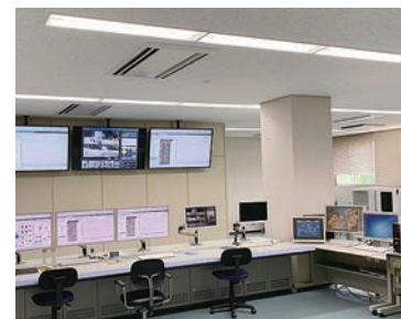
▲管理センターの中央監視室
