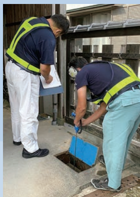
▲漏水音がないか確認
