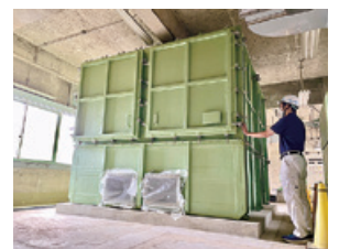
▲汚水処理設備から出る空気を脱臭する装置を更新
