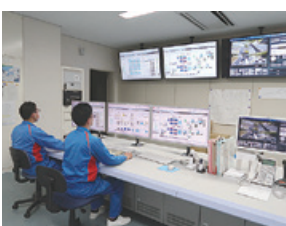
▲監視装置で水道施設を24時間監視
