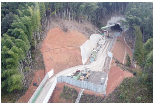
▲境谷トンネル坑口付近 (事業者：国土交通省福知山河川国道事務所提供)
