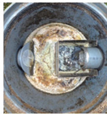
▲汚れたクリーンます
