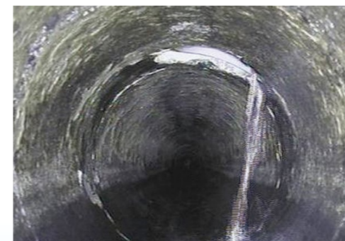
▲老朽化した下水道管
