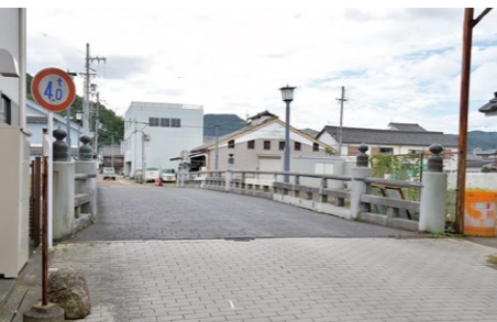
▲高野川に架かる田辺大橋。高野川を自然の外堀とした当時は、城と町をつなぐ唯一の橋であった
