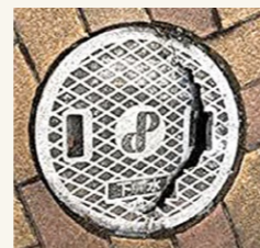
▲壊れた「宅内ます」のフタ
