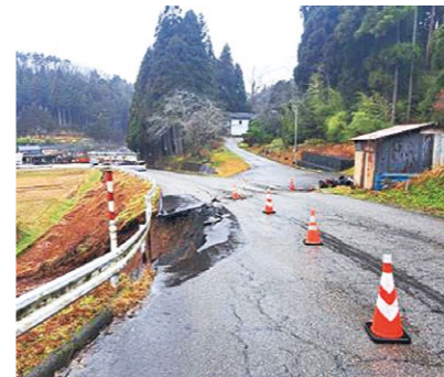
▲陥没した道路
