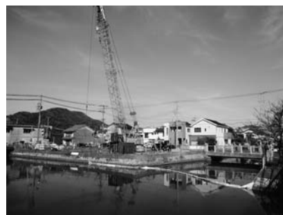
動き出した大手ポンプ場
