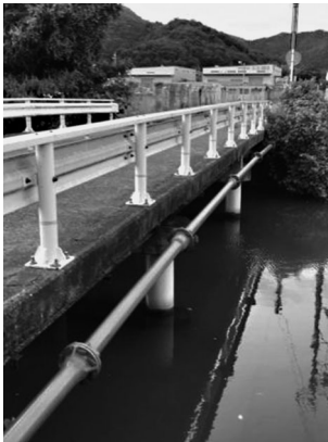
老朽化した橋が多くあり整備が必要
