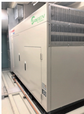
本庁・別館塔屋にある非常用発電機
