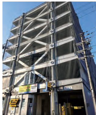
築28年が経過し、老朽化が進む旧マイコム
