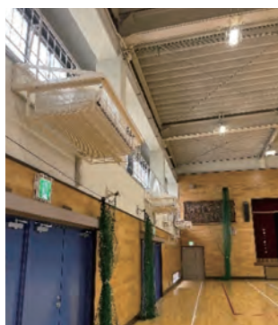
体育館に設置された空調設備（八幡市）
